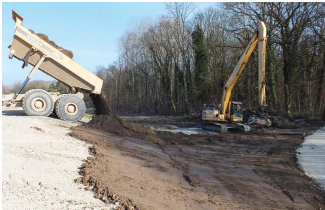
Abbildung 3: Zum Abschluss der Dammertüchtigung wird auf der Wasserseite 10–20 cm Oberboden auf die Kiesschicht, Drainvorschüttung auf dem Stützkörper, aufgebracht. Der Oberboden wurde zuvor auf dieser Damseite entnommen und zwischengelagert. Foto: Reinhold Treiber
